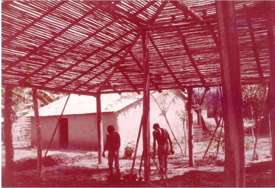
15.- El techo es de guafas
